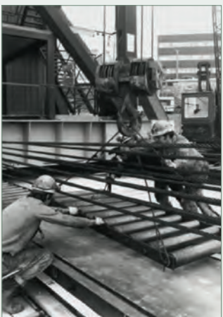
Укладка рольгангов при надвижке копра на ствол № 415 (фото из архива Wismut GmbH).
