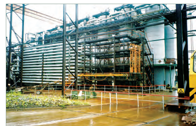
Установка автоклавного выщелачивания.
