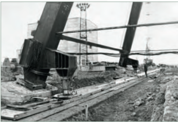
Надвижка копра с помощью кессонов на воздушной подушке (фото из архива Wismut GmbH).
